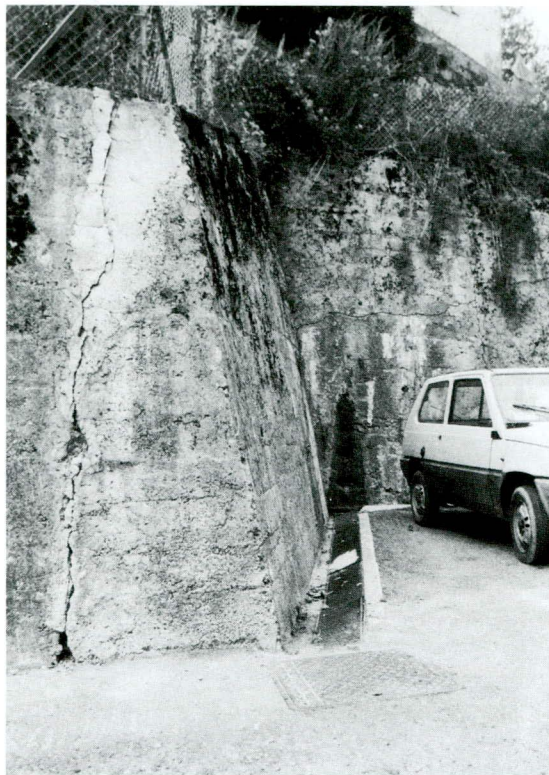
PREZZO - SEGNALI DI ALLARME.
