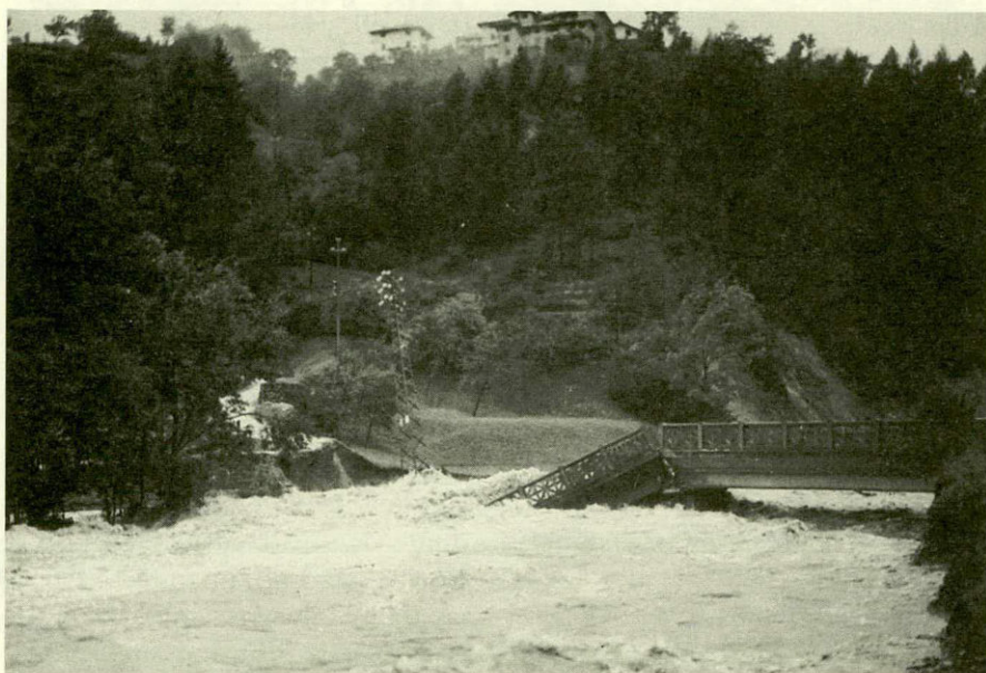
Creto, caduta del ponte sul Chiese che conduce a Prezzo
